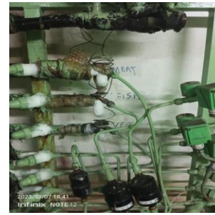
Gambar 3. Pipa-pipa evaporator diselimuti oleh bunga es. Sumber: Dokumentasi Pribadi
