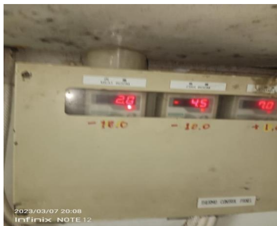
Gambar 4. Thermo control panel. Sumber: Dokumentasi pribadi.
