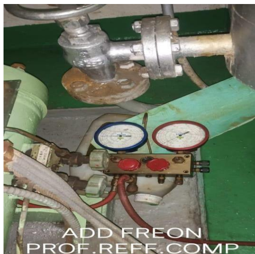
Gambar 6. Add freon provision refrigerator compressor. Sumber: Dokumentasi pribadi.
