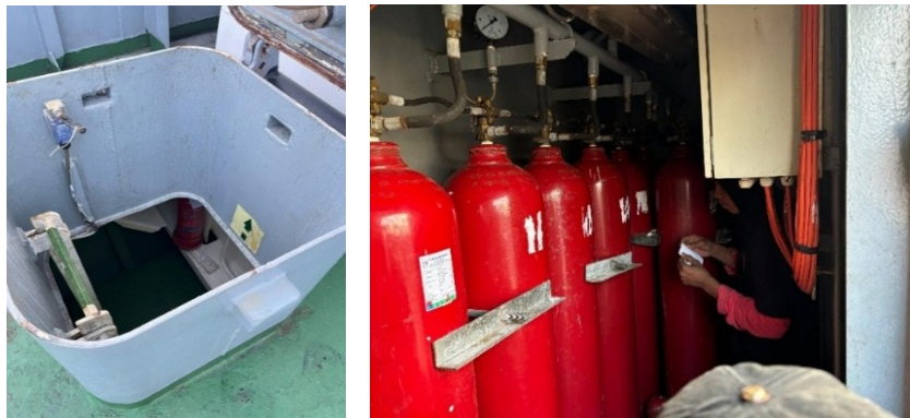
Gambar 1. Penempatan APAR dan ruang CO_2 system yang sulit dijangkau.
